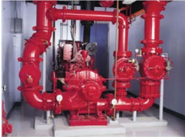
ปั้มน้ำดับเพลิง
